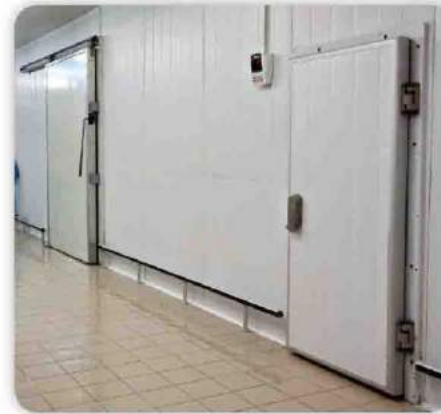
Cold Room Doors / Soğuk Oda Kapıları
